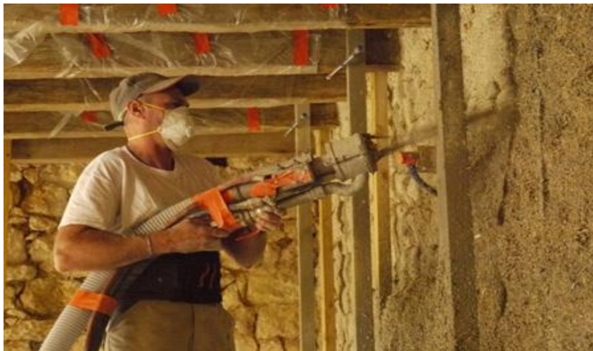
Chantier enduit chaux-chanvre sur la longère de Lurais © PNR de la Brenne
